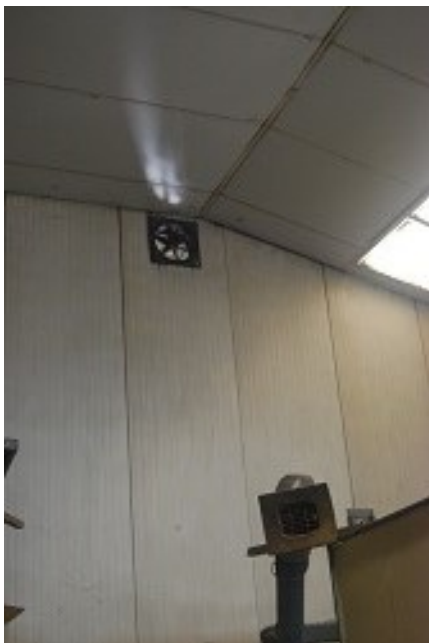
Ventilator te hoog in ruimte aangebracht.
